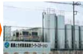
【クーラーステーション (貯乳タンク)】
